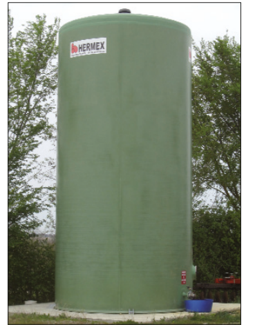
Cuve de stockage d'azote liquide
