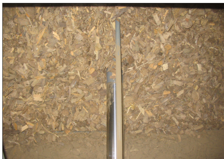
Plaquette forestière sèche dans une trémie d'alimentation de chaudière.
