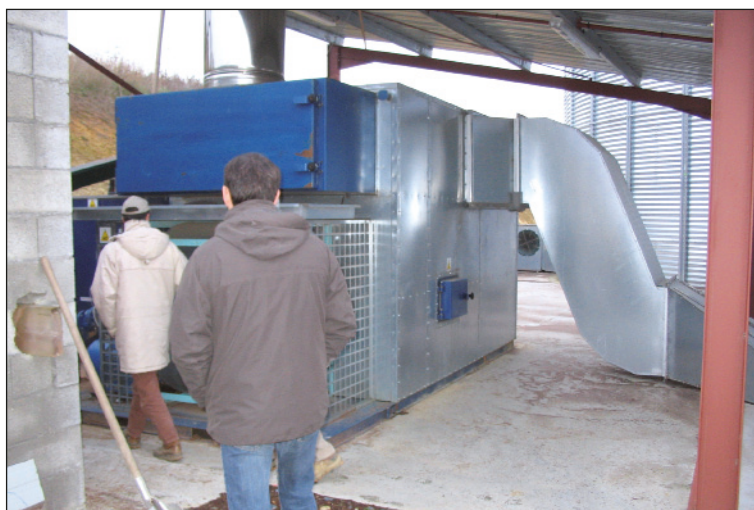
Chaudière à bois en amont d'une cellule sècheuse pour le maïs à l'EARL de la Garenne à BARRAN (32) - (Photo Chambre d'Agriculture du Gers)
