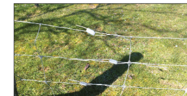
Connexions clôture «grille»
