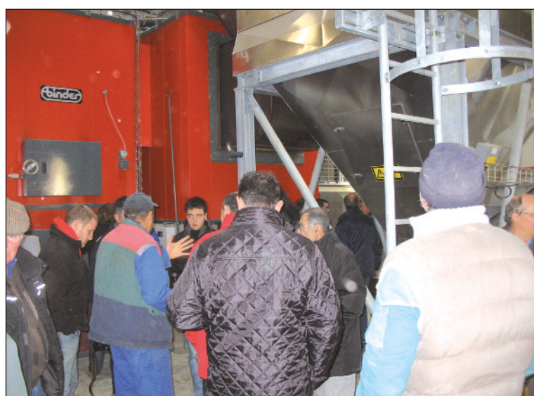
Visite de la chaufferie chez M. ABADIE.
