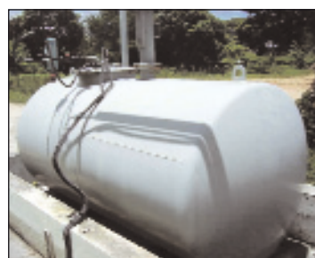
Cuve simple paroi avec bac de rétention en béton.
