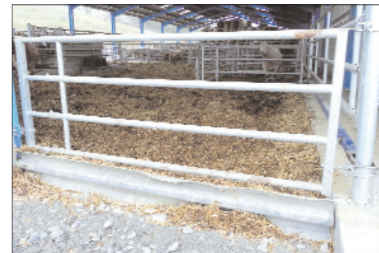
4 L'utilisation de glissière d'autoroute en rétention de la litière permet d'éviter la déformation des portails. Le couloir du passage d'homme a été bétonné au-delà de l'aplomb des barrières afin de faciliter le curage sans être gêné.
