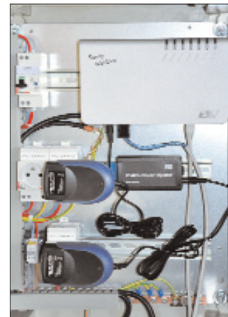
Armoire de télésurveillance connectée à Internet.
