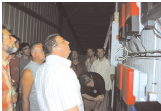
Onduleurs et système de surveillance de l'installation photovoltaïque chez M. LARTIGAU à MASLACQ.
