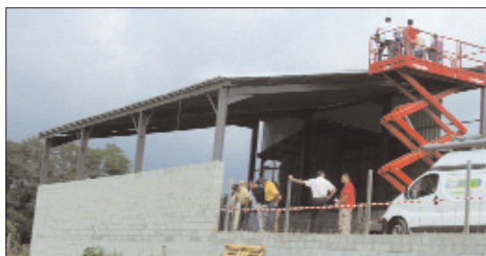
Fumière couverte équipée en panneaux photovoltaïques chez M. PLANTE à PORT de LANNE.
